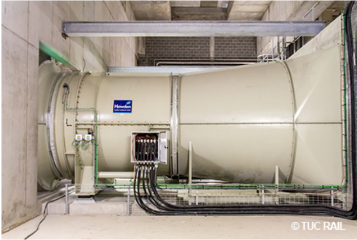
Een ventilator van het rook- en warmteafvoersysteem
